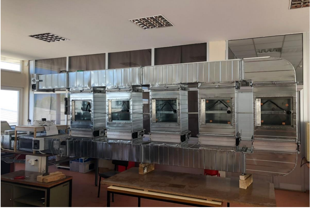
Şekil 2.4 Sistemin Monte Edilmiş Hali
