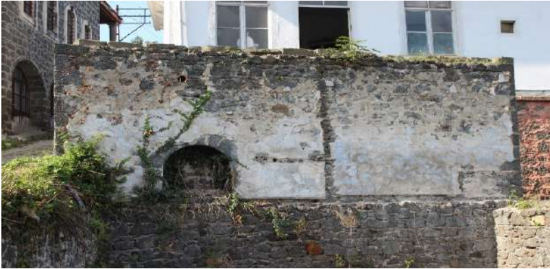
Şekil 12. Kuzey Cephe iç duvar yüzeyinde yer alan yok olmuş bölücü duvara ait sıva izi görünümü
